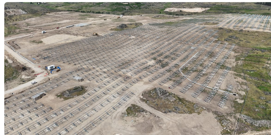
Figura 6: Parque Solar Fotovoltaico PV Riodades | Portugal
