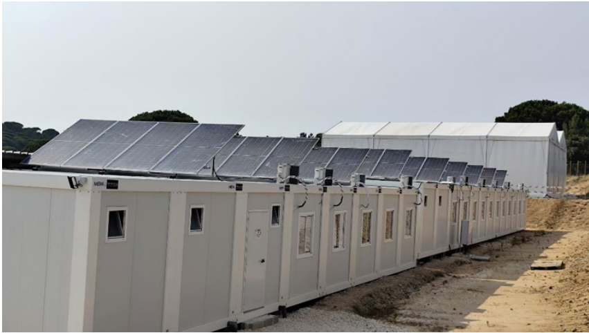
Figura 10: Parque Solar Fotovoltaico PV Cibeles | Portugal
