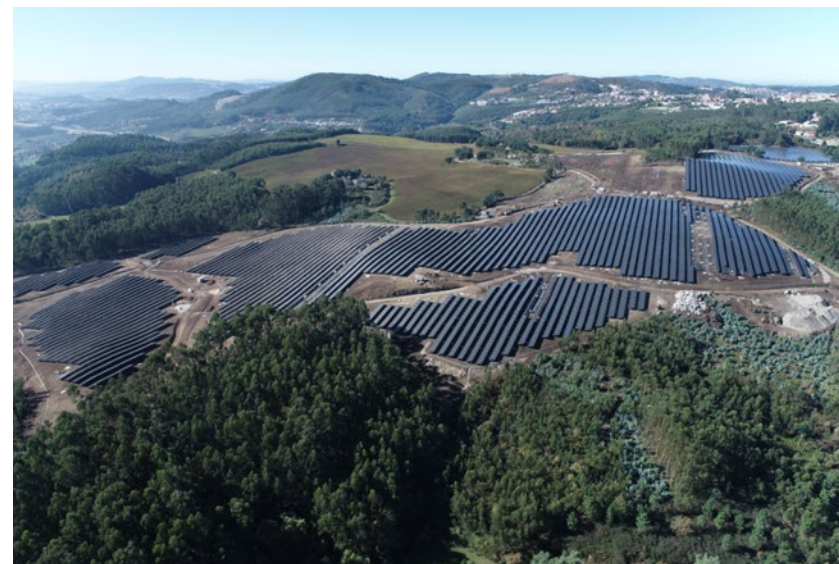
Figura 3: Parque Solar Fotovoltaico + BESS, PV Felgueiras | Portugal
