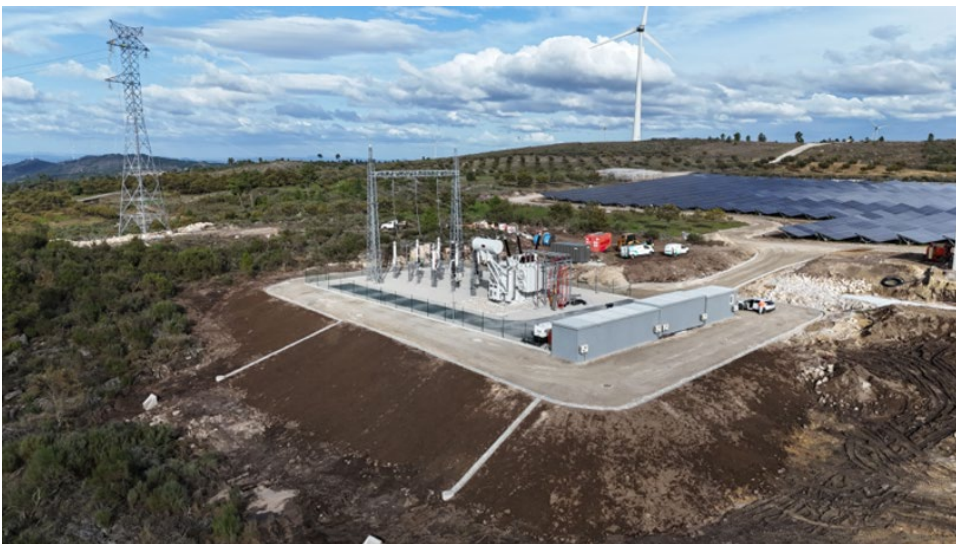
7 Figura 4: Parque Solar Fotovoltaico PV Douro | Portugal
