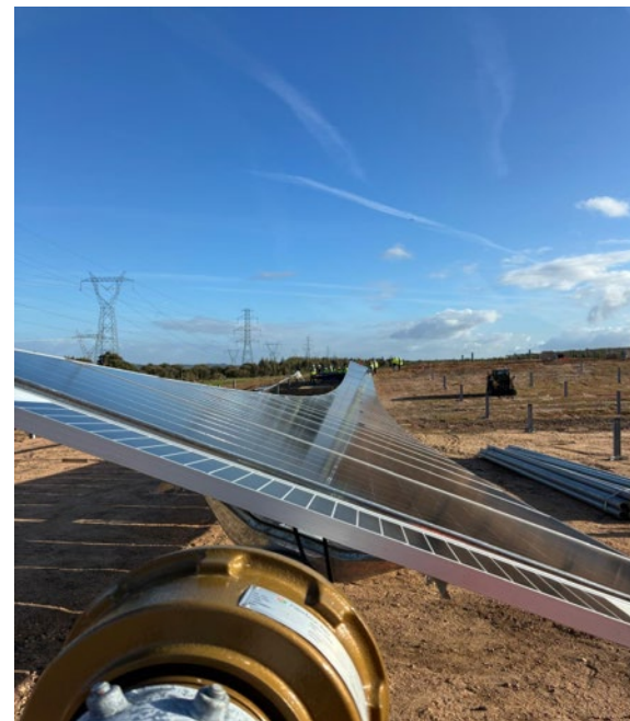
7 Figura 11: Parque Solar Fotovoltaico PV Cibeles | Portugal
